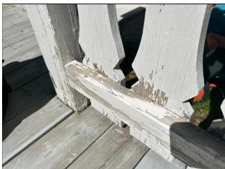
Tilstand på rekkverk og overflatematerialer - -
