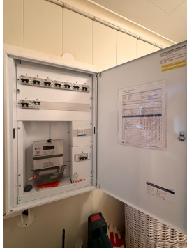
Sikringskap med automatsikringer.
