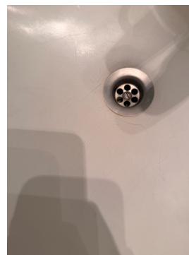
Oppsprekninger og småriss i servanten.
