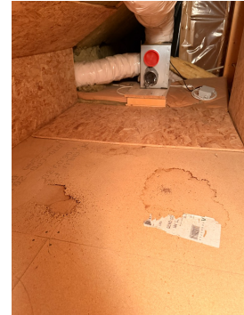
Fuktskjolder på gulvspan i kneeloft.
