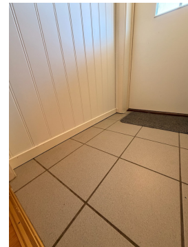
Gulv i entre med lokalt høydeavvik.
