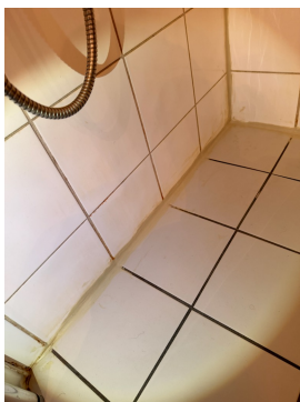
Fugingen i dusjen fremstår ufagmessig utført.
