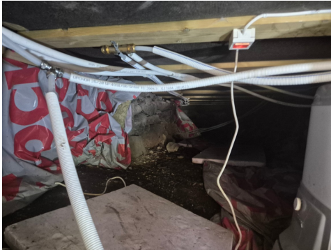
Vannrør i krypkjeller
