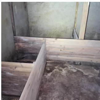
Helhetsvurdering - Eksempel på slitasjer og fuktskader
