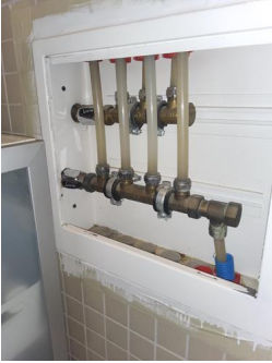
Fordelerskap og fordelerstammer - Fordelerskap for rør-i-rør og stoppekraner
