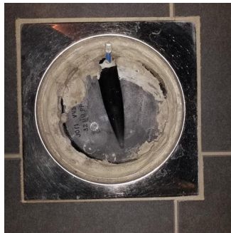
Vannnett sjikt / membran i gulv og vegger - Hjelpesluk under servant.
