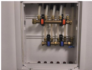
Fordelerskap og fordelerstammer - Fordelerskap
