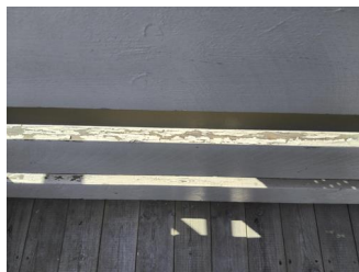
Tilstand på rekkverk og overflatematerialer - Slitasje på skillevegg
