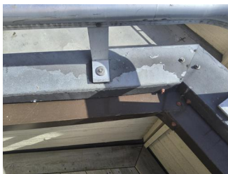
Tilstand på rekkverk og overflatematerialer - Overflateslitasje på rekkverk
