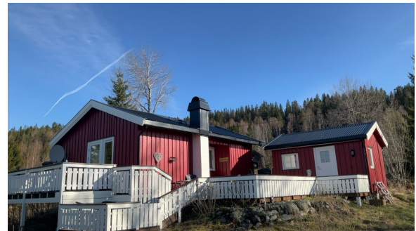
Det mangler tilfredsstillende adkomst til pipe for feier.
