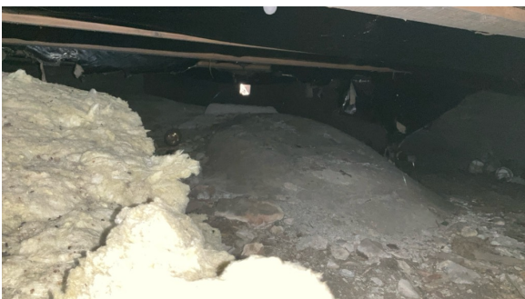
Edderkoppbord er observert hengende fra bjelkelag, det vitner om fuktig klima.
