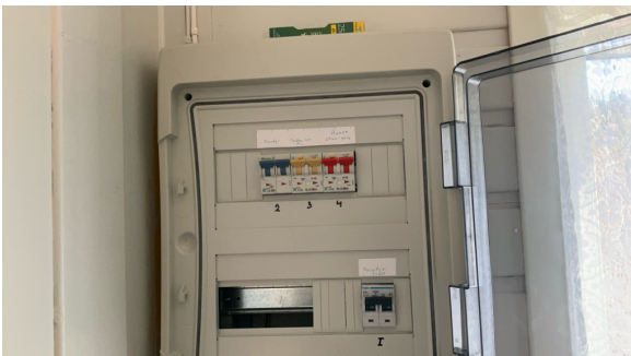
Sikringsskap med automatsikringer er plassert på toalettrom
