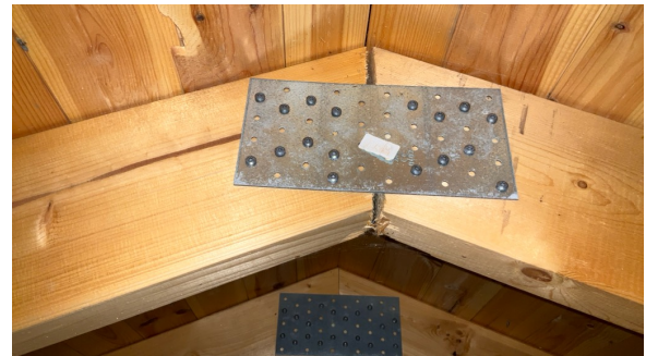
Glipper mellom sammengøyninger av taksperre. Følg med på tilstanden og påse at snømengden ikke blir for stor på taket.
