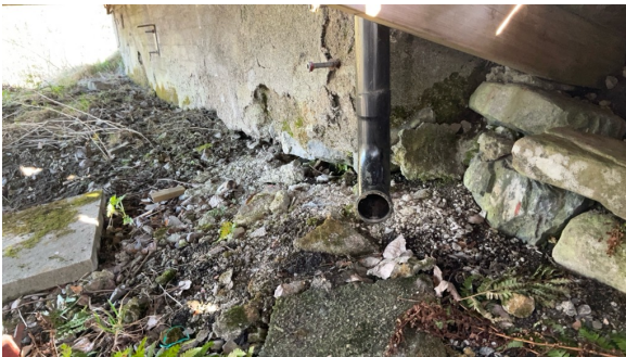
Takvannet ledes ikke vekk fra bygningen.
