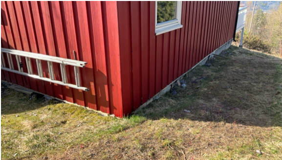
Stedvis fall på terreng mot bygning.
