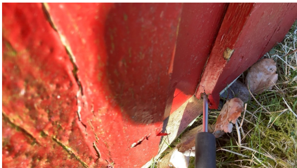
Lav høyde mellom kledning og bakkenivå. Det er observert råte på enkelte kledningsbord.
