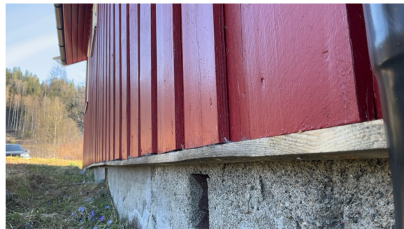
Skjevheter i vegg.
