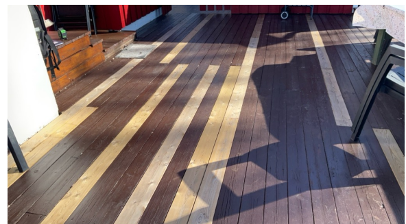
Enkelte bord er skiftet ut og er ikke beiset.
