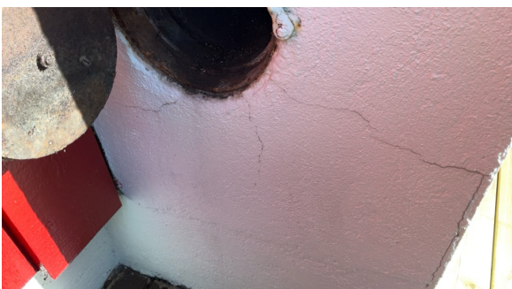
Det er observert sprekker/riss i pipe utvendig.
