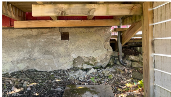
Sprekker og skjevheter i mur. Stedvis utvaskinger under mur. Det anbefales at det isoleres rundt grunnmur for å unngå ytterligere frost og tele.
