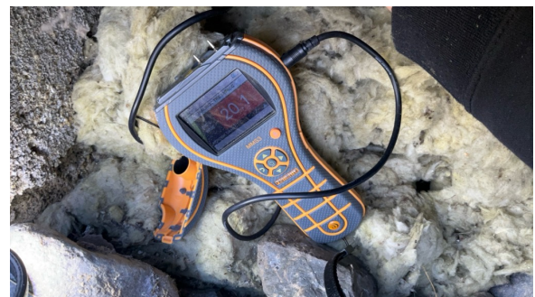
Fuktmålingene som ble foretatt i svill viser forhøyede fuktverdier som er skadelig for treverket. Målingene er foretatt i bjelkelag over inspeksjonsluke.
