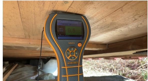
Fuktmåling ble foretatt, jeg målte tørre verdier i trevirke. Det gjøres oppmerksom på at utført måling kun er en stikkprøve.
