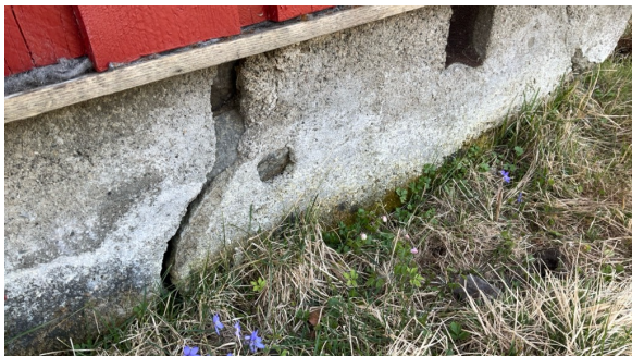
Sprekker i mur. Løs puss.
