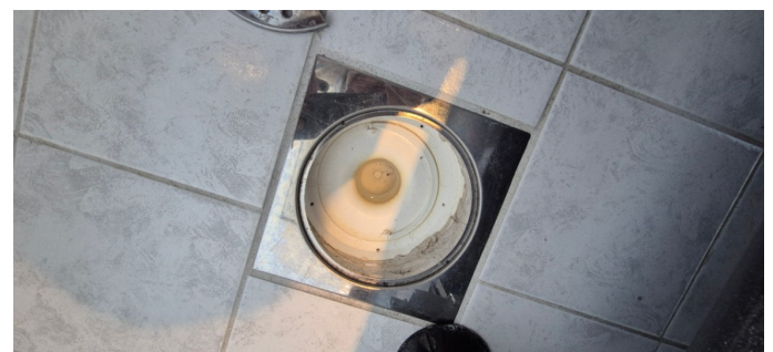
Sluk under dusjkabinett
