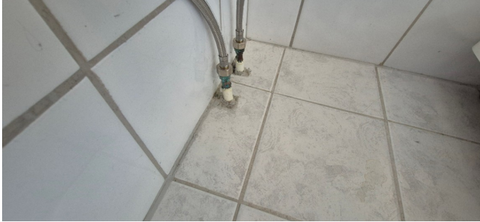
Rør gjennom gulv
