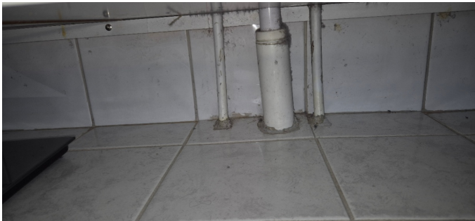
Rør gjennom gulv
