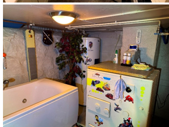
Sanitærutstyr i kjellerrom
