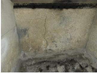
Ildsteder - Sprekk i peis
