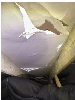
Synlige overflater (taktro, vegger, gulv, o.l.) - Skader i branngips
