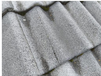
Tekking (med tilhørende beslag) - Sprukket takstein
