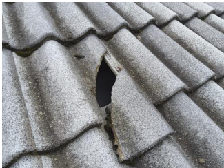
Tekking (med tilhørende beslag) - Knekt takstein
