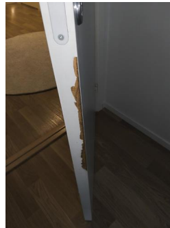
Innerdører - Skade i soveromsdør
