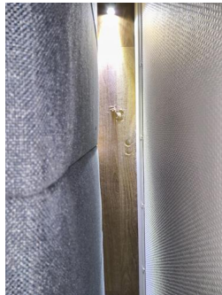
Overflate gulv - Skader i belegg bak sofa
