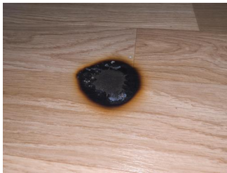
Overflate gulv - Svimerke ved peisovn
