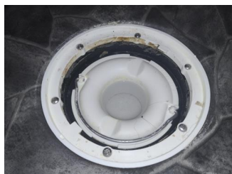
Tettesjiktets tilslutning til sluk - Sluk i dusj
