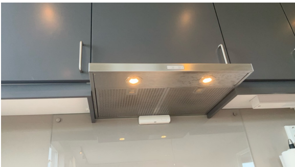
Kjøkkenventilator er funksjonstest på befaringsdagen og funnet OK.
