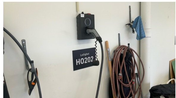
Parkeringsplass i kjeller med opplegg for EL-bilalder. Parkeringsplass er merket H0202
