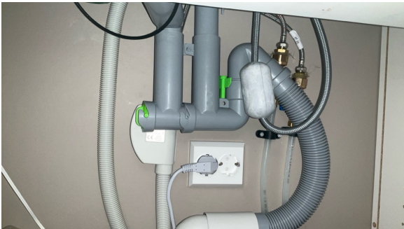
Benkeskap. Det er montert vannstoppventil med sensor under innredning.
