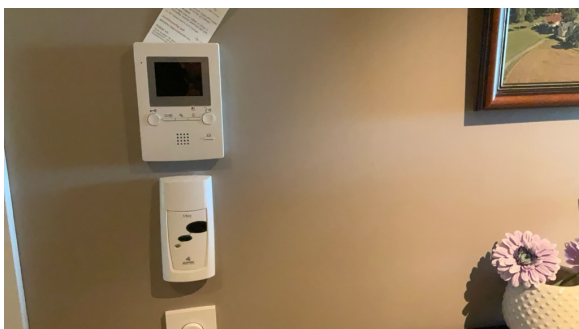
Porttelefon er montert i leiligheten med fjernbetjening av ytterdør.
