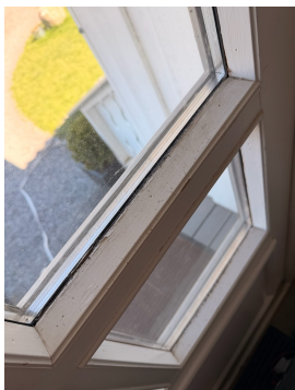
Tegn på innvendig kondensering rundt vindusglass.
