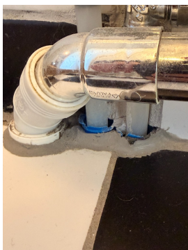
Gjennomføringer i gulv er ikke tilstrekkelig tett mot fukt.
