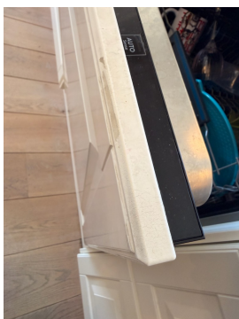
Oppsprukket lakkering på oppvaskmaskinfronten, trolig som følge av fuktig luft ved bruk av oppvaskmaskina.
