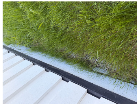
Ikke synlig tegn til fuktsikring av grunnmuren over terreng.
