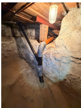
Synlige avløpsrør i kjeller utført i plast.
