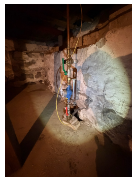
Inntak med hovedstoppekran.
