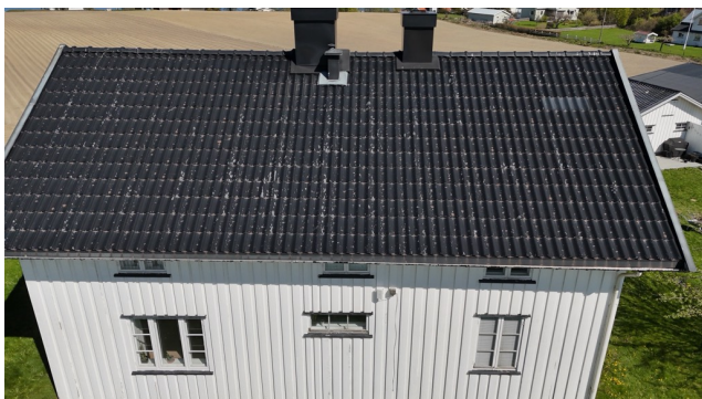
Taktekingen flasser, og det er påvist rustdannelse.
