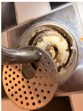
Sluket har noe vanskelig tilkomst, og inspeksjonen kan derfor være mangelfull.
