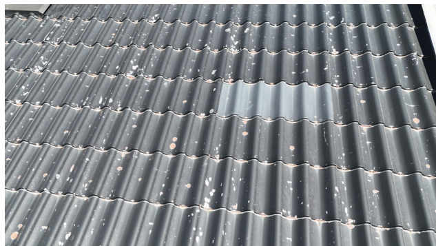
Rustdannelser der lakken flasser.
