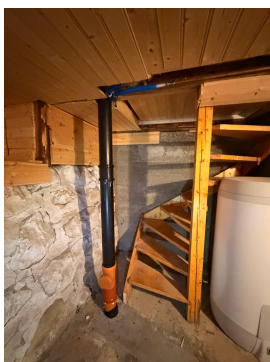
Synlige avløpsrør i kjeller utført i plast.
