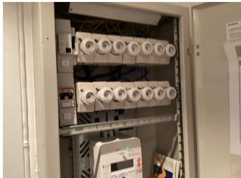
Bilde av sikringskap.
