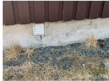
Sprekker i grunnmur
