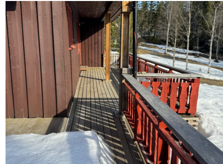
Skjevheter i terrasse
