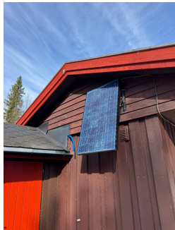
Solcellepanel montert på yttervegg
