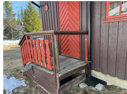
Trapp ved inngang der deler av rekkverk mangler
