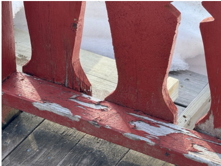
Slitte overflater på terrasse
