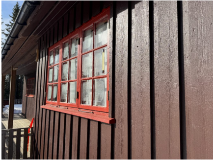
Eldre vinduer der det ikke er montert beslag under vinduer
