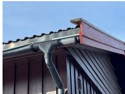
Slitasje og skade i overflater av takrenner
