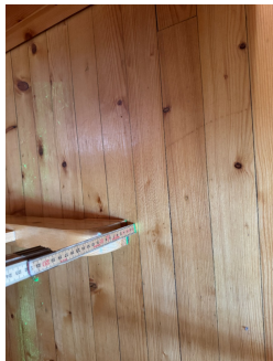
Skjevhet på 5 cm på innvendige gulvoverflater
