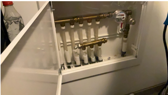
Innvendig hovedstoppekran og vannmåler er plassert i samleskap på teknisk rom/ bod.
