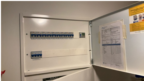
Sikringskap med automatsikringer er plassert i teknisk rom/bod.
