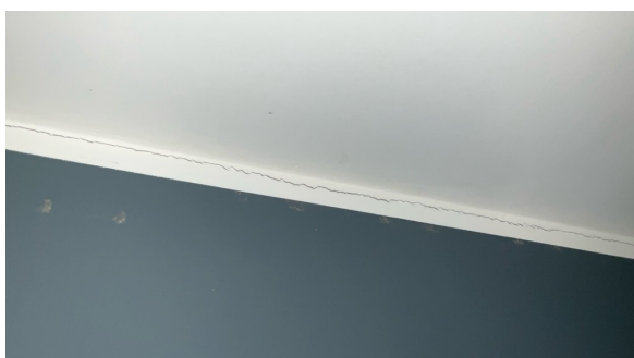
Sprekker i overflater i overgang mellom vegg-tak.
