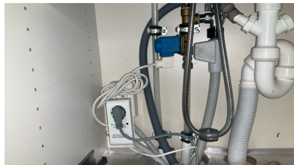
Benkeskap. Det er montert vannstopppventil med sensor under innredning.
