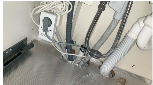
I kjøkkenskap er det ikke tett tilslutning mellom varerør og vannrør på rør i rør opplegget.
