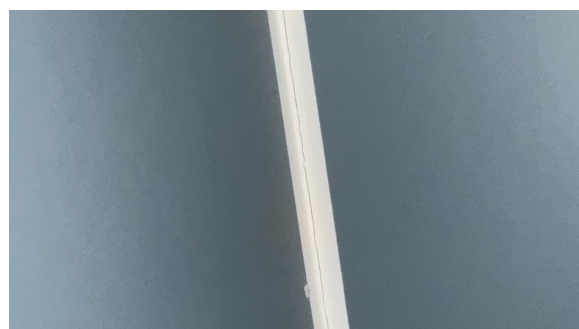
Sprekker i overflater i overgang mellom hjørner.
