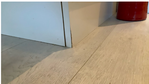
Mindre skade på sokkel.
