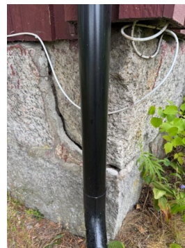
Forskyvning av stein i grunnmuren.
