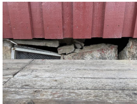
Skader i muren ved kjellerrommet.
