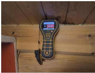
Overflate himling - Fuktmåling soverom
