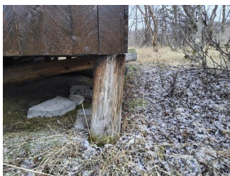
Fundament, grunnmur og gulv mot grunn - Skjevheter i fundament
