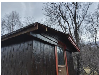
Yttertak og takkonstruksjon - Skadet vinsj og vannbord
