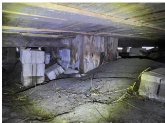
Annet - Råteskader rundt fundament til pipe
