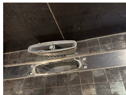
Slukrenne i dusjsone.
