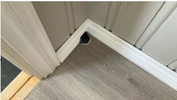
• Synlig avløpsrør i gulvet i entré. Ikke fagmessig utførelse.
