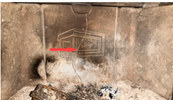
Det er påvist sprekker i ildfast stein inne i ovnen.
