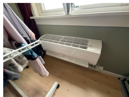
Varmepumpe i 1. etasje
