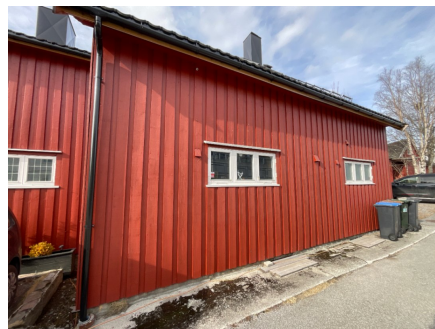
Ikke montert musebørste i nedre kant av panelet på østvegg.
