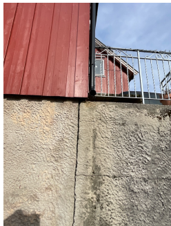
Fuktpåvirkning mot mur fra taknedløpet.
