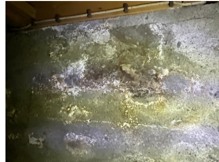
Innvendig misfarging og slitasje.
