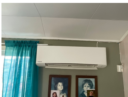
Varmepumpe i 2. etasje
