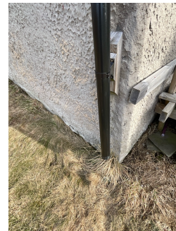
Takvann er stedvis ikke ledet bort fra grunnmur
