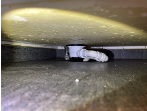
Sluk under dusjkabinett.
