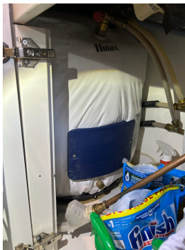
Varmtvannsbereder i kjøkkenskap.
