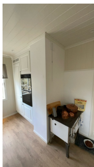
Bildet viser ikke synlig pipevange og ikke tilkoblet vedkomfyr på kjøkkenet i 1. etasje.
