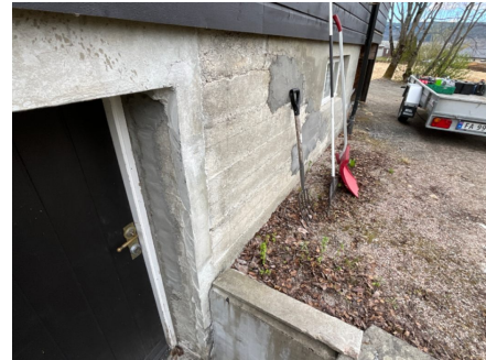
Upusset grunnmur ved kjellerinnang.
