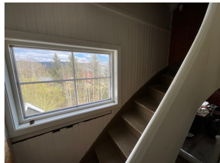
Det er ikke håndløper i innvendige trapper.
