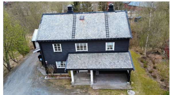
Avskalling, misfarging og rust på pipebeslag, mønebslag og gavlbeslag.
