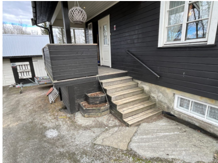
Trapp til hovedytterdør mangler rekkverk.
