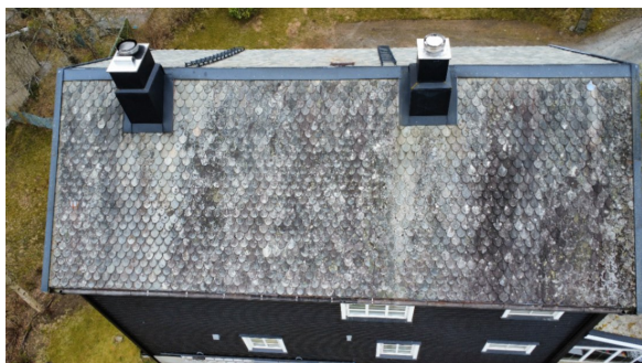
Oversiktsbilde, nordside av hovedtak. Bildet viser mosevekst mot vest.
