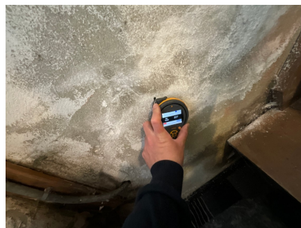
Påvist fuktindikasjon, avflassing av maling og saltutslag på betongvegg ved trapp.
