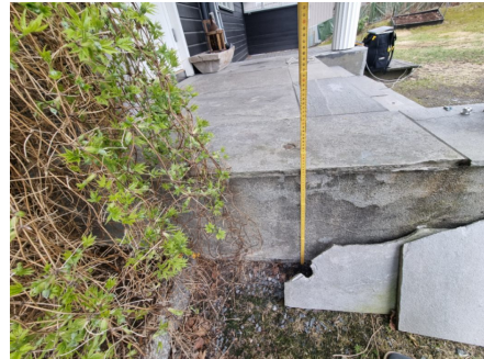
Trapp til balkongdør mangler rekkverk.
