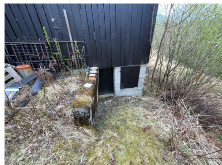
Støttemur mangler rekkverk
