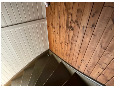
Skruer stikker ut av veggen i trappeløp til kaldloft
