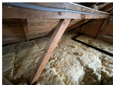
- Lufteøret er på kaldloft lagt horisontalt på Himlingsisolasjonen og ført ut gjennom yttervegg.
