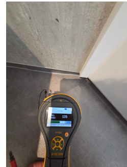
Fuktsøk er utført på gulv ved toalett. Ingen forhøyde fuktavvik er målt
