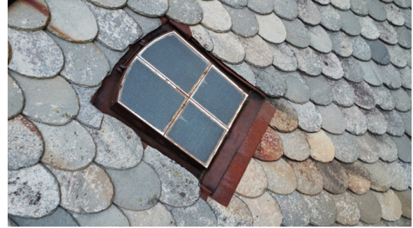
Rust på beslagsløsning rundt takvindu.
