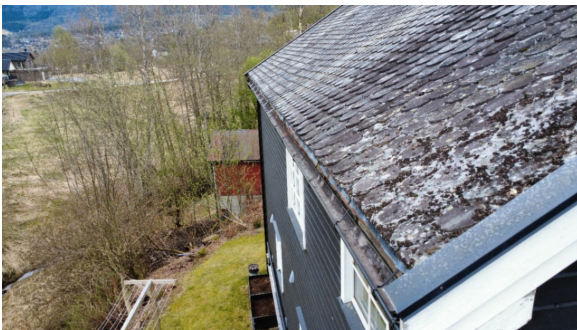
Rust på takfotbeslag.
