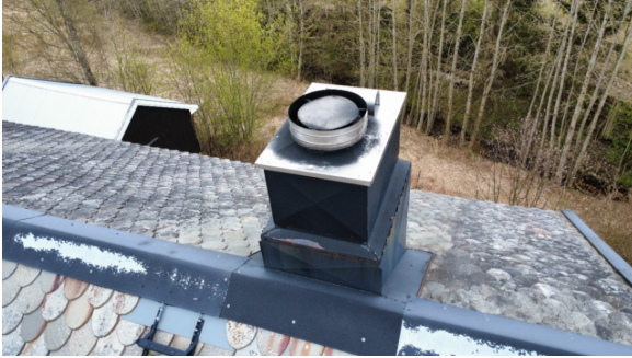
Avskalling, misfarging og rust på pipebeslag og mønebslag.
