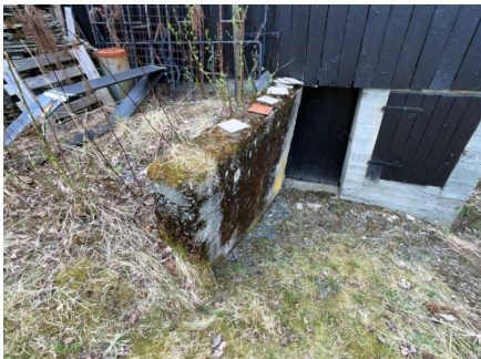
Forstøtningsmur med store skjevheter.
