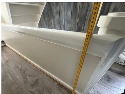
Rekkverk i gang i 2 etasje med høyde ca. 60 cm.
