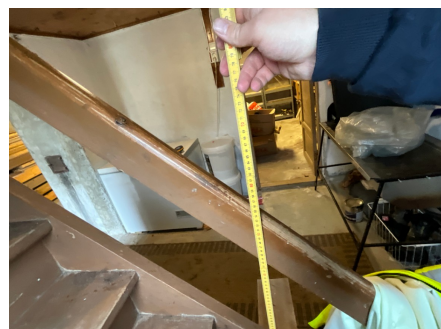
Rekkverk kjellertrapp med høyde ca. 56 cm og store åpninger.
