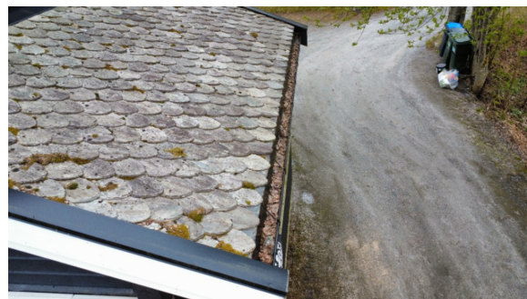
- Takrenne over inngang er tett av løv, barnåler og annet rusk.
