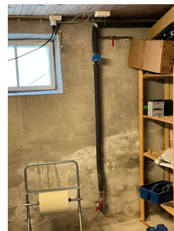
Innvendig stoppekran og kobberør frem til fordelerstokker.
