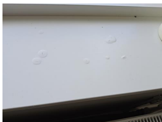
Vinduer og omramming - Skader i foringer stue.
