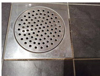
Overflater gulv - Skader i flisefuger.
