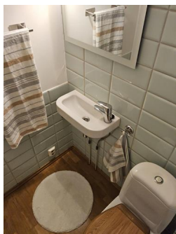
Sanitærutstyr og innredning - Toalettrom
