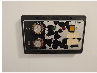
Tekniske anlegg (kjøleaggregat, badstueovn med mer) - Ovn er koblet ut
