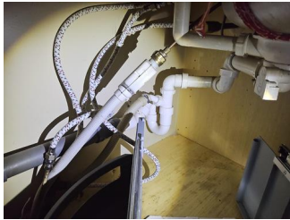
Innredning - Røropplegg i kjøkkenbenk
