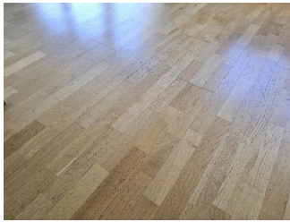
Overflate gulv - Slitasje på gulv
