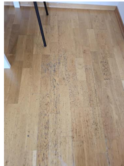
Overflate gulv - Slitasje gulv
