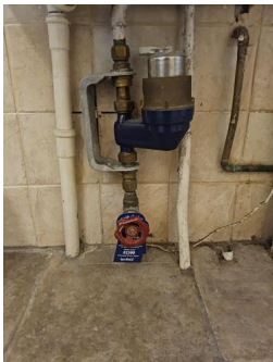
Innvendig stoppekran - Stoppekran og vannmåler
