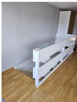
Rekkverk og håndløper - Åpninger i rekkverket større enn 10 cm
