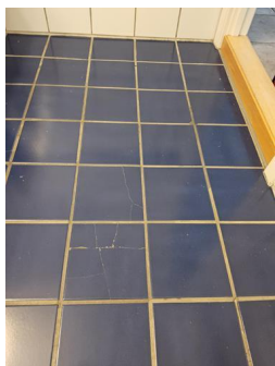
Overflater gulv - Høy slitasje på gulv, med blant annet knekte flis.
