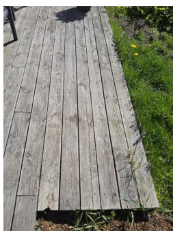
Tilstand på rekkverk og overflatematerialer - Høy slitasje på terrasse
