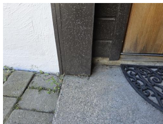
Ytterkledning (fasademateriale, vannbord, utvendig listverk, o.l.) - Liten klaring til terreng
