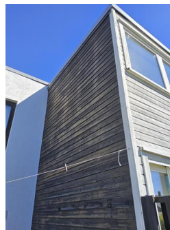
Ytterkledning (fasademateriale, vannbord, utvendig listverk, o.l.) - Ikke tilstrekkelig luftet
