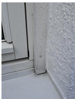
Vinduer og omramming - Tegn på råtedannelse endeved av sidebelistning
