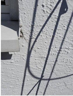
Grunnmur og fundament - Riss
