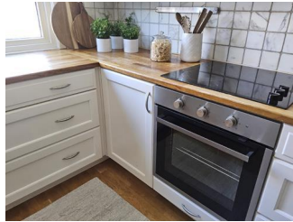
Innredning - Stedvis slitasje og bruksmerker. Innredning fra 2004.
