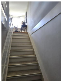
Rekkverk og håndløper - Ikke håndløper på begge sider
