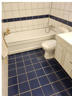
Vanntett sjikt / membran i gulv og vegger - Vurdert til å være membran fra byggeår.
