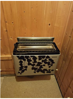
Tekniske anlegg (kjøleaggregat, badstueovn med mer) - Badstue ovn
