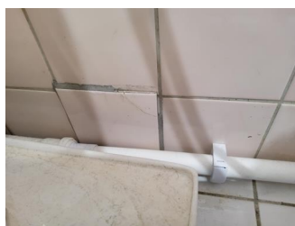
Fagmessig utførelse - Ufagmessig arbeid i gulv/veggfliser på bad.
