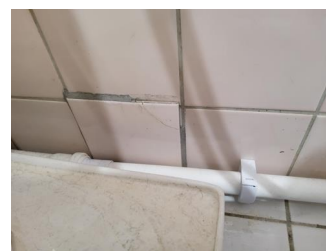
Avløp (inkl. sluk) - Sprekk i veggflise.
