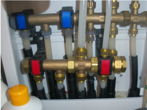
Rør-i-rør skap plassert i innredningen i vaskerom
