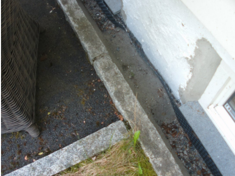
Manglende topplatt på grunnmursplast
