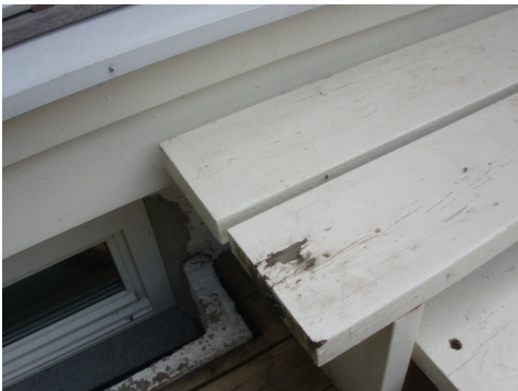
Noe råteskade i trapp
