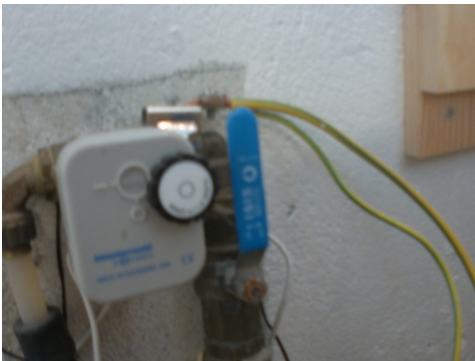
Stoppekran kommer inn i vaskerom.
