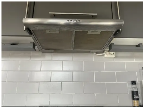
Mekanisk avtrekk over koketopp
