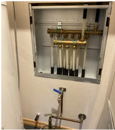
Fordelerskap i innvendig bod/teknisk rom
