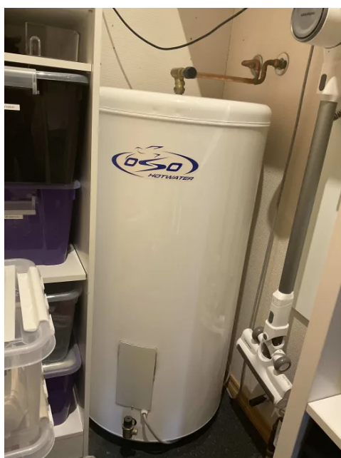
Bereder plassert inne på teknisk rom
