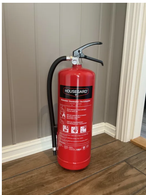
Brannslukningsapparat plassert inne på teknisk rom
