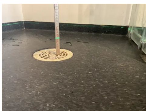
Gulv med mangelfullt fallforhold
