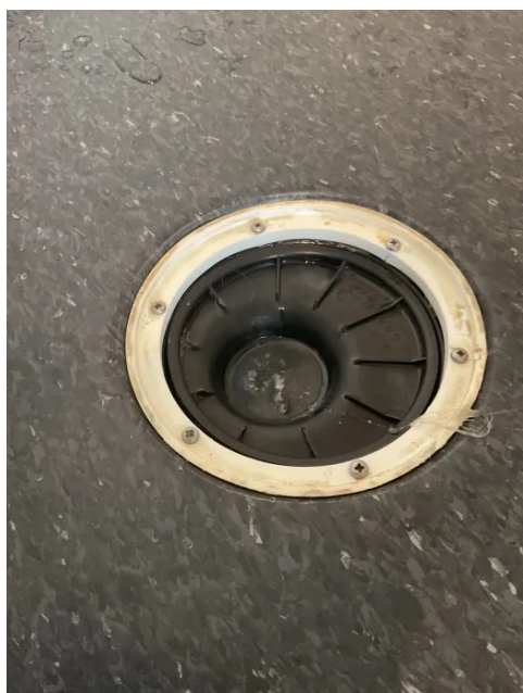
Gulvbelegg synlig ført under klemring
