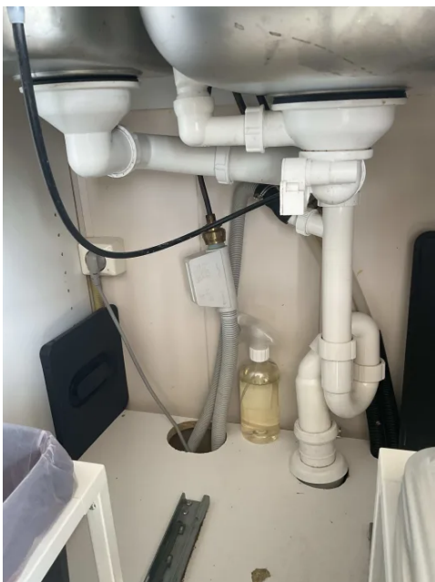
Synlige innvendige avløpsrør i PVC-plast
