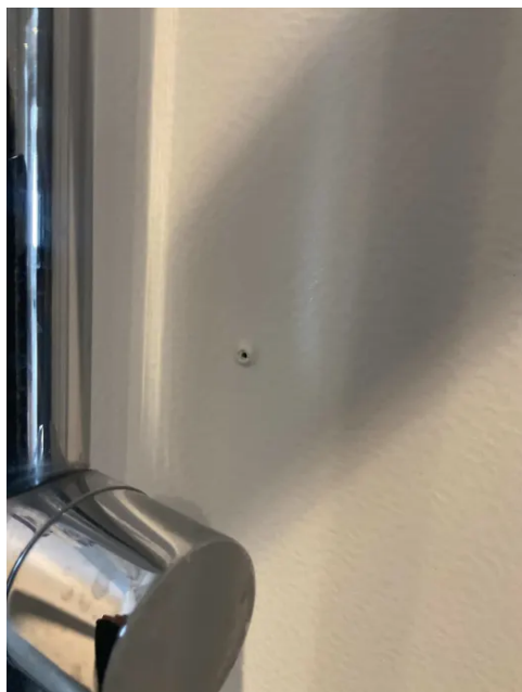
Veggoverflater med enkelte hulldannelser
