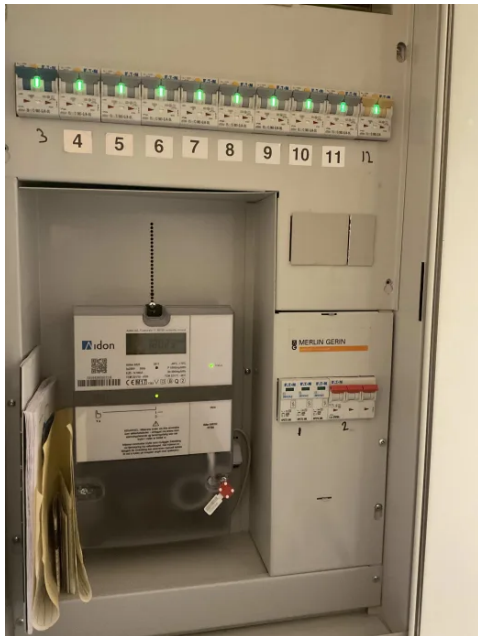
Sikringskap med jordfeilautomater plassert inne på teknisk rom
