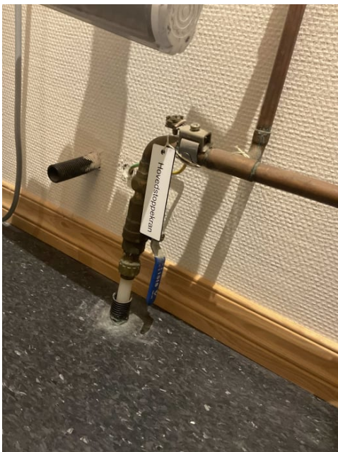
Hovedstoppekran med synlig merking
