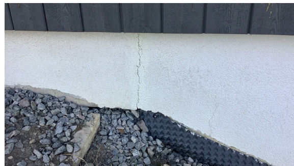
Sprekke/riss i murpuss i overgang til plate på mark for bod.
