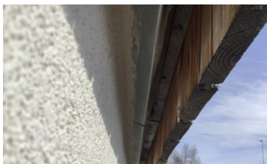
Redusert lufting bak kledning enkelte steder.
