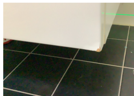
Det er svelling i innredning etter vannpåkjenning.
