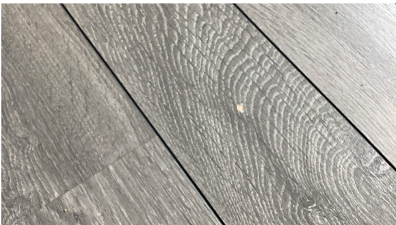
Enkelte hakk/sår i laminat.
