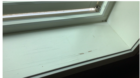
Utforinger i vinduer har vedlikeholdsbehov.
