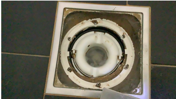
Det er synlig membran under klem-ring i sluk.
