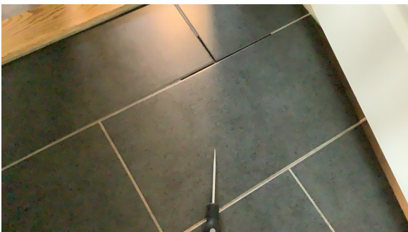
Løse fliser på gulv i hybel gang mot soverom
