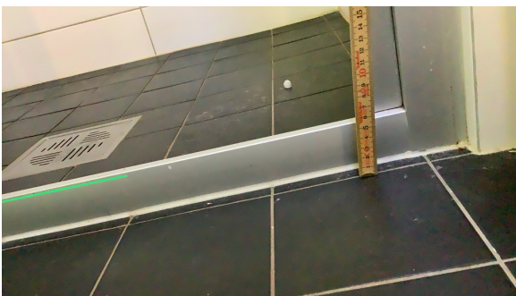
Fast sokkel på dusjvegger hindrer evt lekkasjevann å renne til sluk
