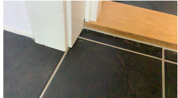
Det er ikke etablert oppkant av membran over topp flis ved terskel.
