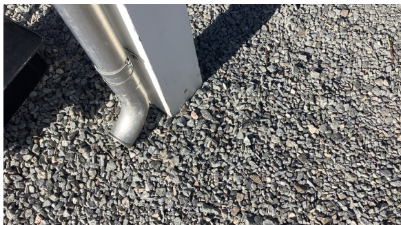
Bæresøyle for carport går ned i terrenget. Fare for fuktopptrekk og skader.
