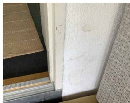
Løs puss på murfasade.
