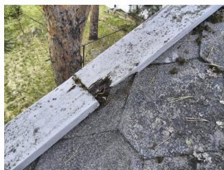
Yttertak og takkonstruksjon - Skade på vannbord
