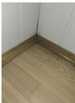
Overflate vegg - Misfarging på soveromsvegg i leilighet
