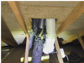
Kondensisolering av rør og ventilasjonskanaler - Uisolerte rør
