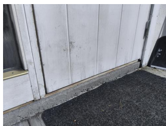
Ytterdører og omramming - Slitasje på dør til leilighet
