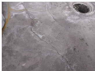
Overflate gulv - Salt/kalk utslag og sprekker i støpt gulv
