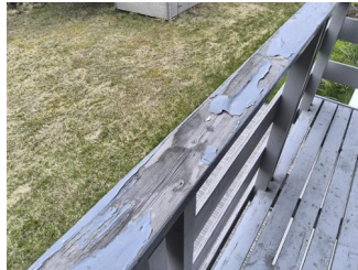
Tilstand på rekkverk og overflatematerialer - Slitt overflatebehandling
