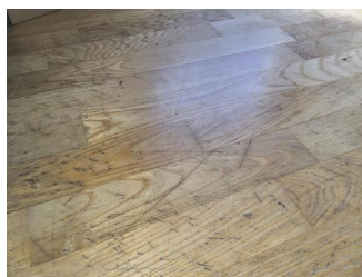
Overflate gulv - Slitasje og skader i parkett
