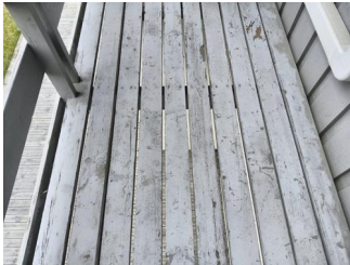
Tilstand på rekkverk og overflatematerialer - Slitt overflatebehandling
