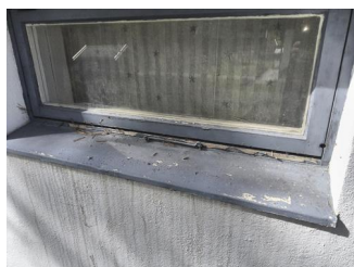
Vinduer og omramming - Utvendig slitasje på vindu fra byggeår
