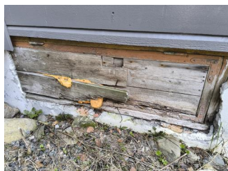
Vinduer og omramming - Skadet vindu uten glass
