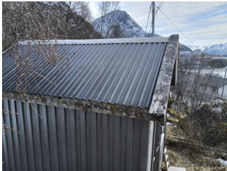
Yttertak og takkonstruksjon - Råteskader i vannbord og forkantbord
