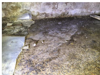
Kontroll i lukkede konstruksjoner ikke utført - Tilsig av fukt
