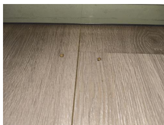
Overflate gulv - Skruhull i gulv
