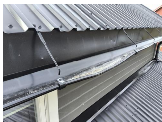
Takrenner og utvendige nedløp - Skader i tak renne
