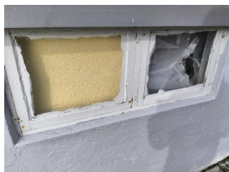
Vinduer og omramming - Sterkt slitt vindu
