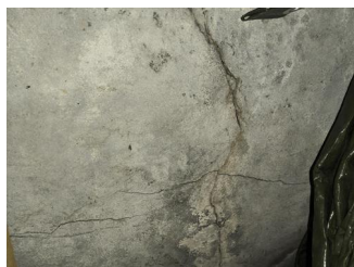
Overflate vegg - Sprekker i grunnmur i entre
