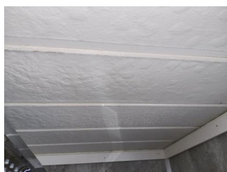
Overflater himling - Svelleskader i himling over dusj
