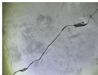
Overflate vegg - Sprekker i grunnmur i entre
