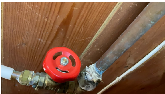
Det er påvist irr/korrosjoner på rør og koblinger
