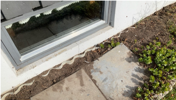
Asbestholdige plater observert mot utvendig grunnmur.
