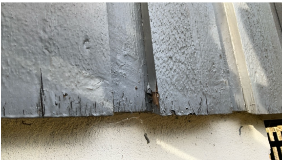
Kledning bærer stedvis preg av elde og slitasje.
