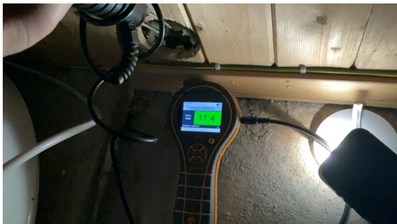
Fuktmåling med pigg mot våtrom: Det ble ikke målt forhøyde fuktverdier ved hulltaking på befaringstidspunktet.
