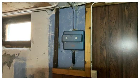
Strøminntak med skrusikring er plassert i kjeller.
