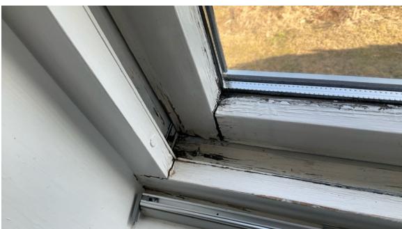
Det er observert råte nederst i vinduskarm.
