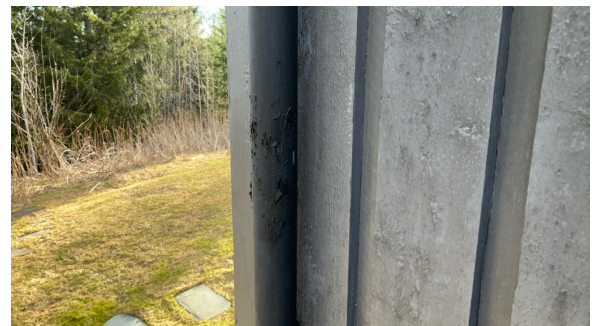
Noe flassing på takrenner og beslag.
