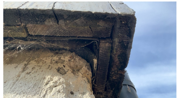
Sprekker i kledning. Lufting av kledningen er ikke iht. dagens anbefalte løsning. Det er observert glipper/åpninger i overganger/lufting i veggkonstruksjon der skadedyr kan komme inn.
