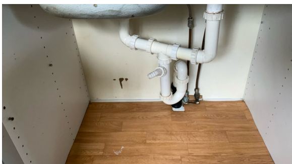
Benkeskap. Det anbefales å montere vannstoppventil med sensor under innredning.
