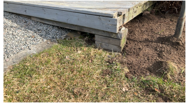
Konstruksjonen er ikke bygget på frostsikker grunn, bevegelser og skjelheter vil derfor kunne forekomme.
