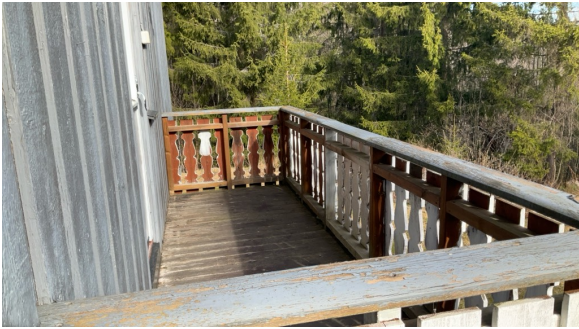
Konstruksjoner/overflater er værslitte.
