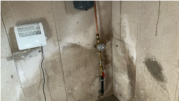
Innvendig hovedstoppekran og vannmåler er plassert i bodrom i kjeller.
