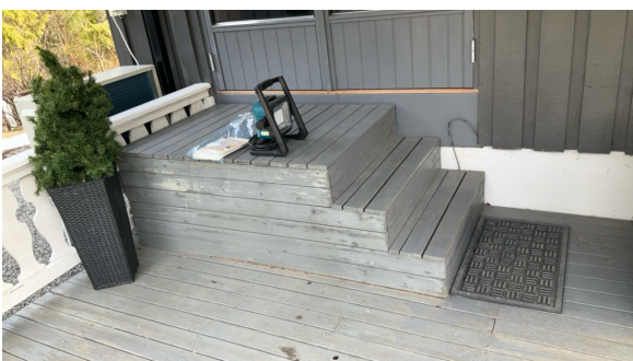
Trapp mangler rekkverk.
