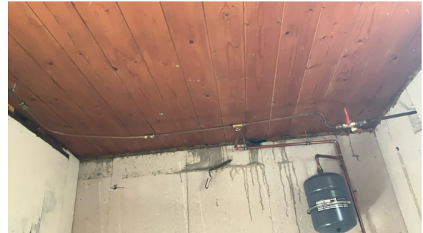
Utilstrekkelig klamring av vannrør registrert.
