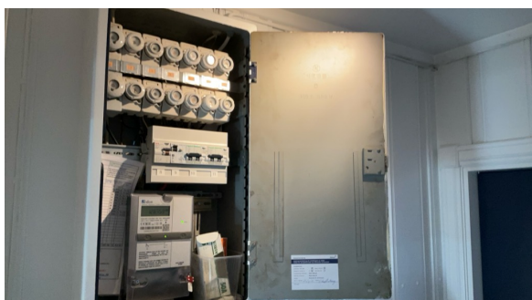
Sikringskåp med skrusikringer er plassert i entre.
