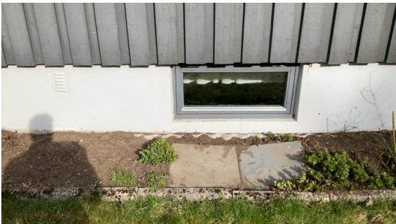
Lav høyde mellom terreng og kjellervinduer.
