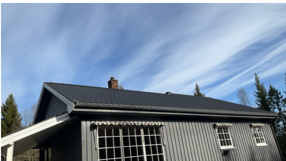
Det mangler snøfanger på takflatene.
