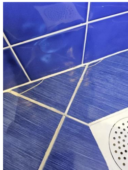
Overflater gulv - Riss i gulvfliser.
