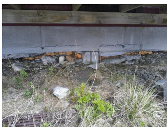
Grunnmur og fundament - Sprekker i grunnmur
