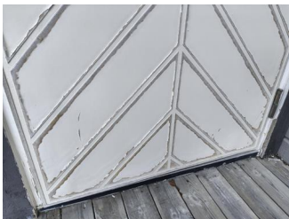
Ytterdører og omramming - Slitt ytterdør med tegn til fuktoppsug
