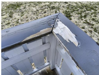
Tilstand på rekkverk og overflatematerialer - Slitt overflatebehandling
