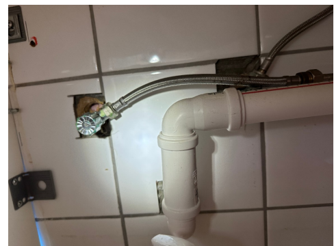
Utette rørgjennomføringer i vegg.
