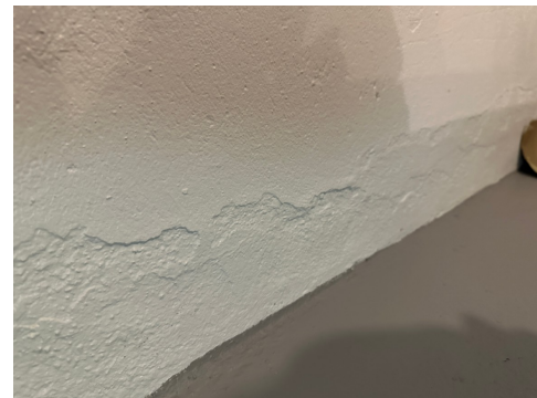
Tegn til saltutslag (nymalt ved befaring)
