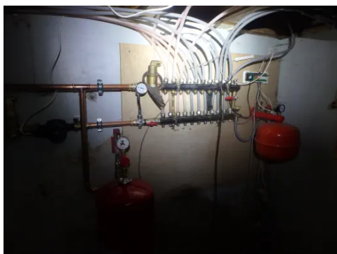
Rørstokk i kjeller for vannbåren varme.
