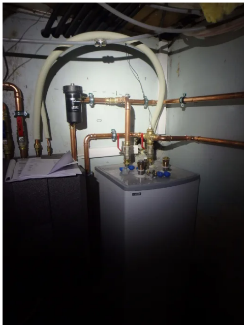
Anlegg for vannbåren varme på teknisk rom i kjeller.
