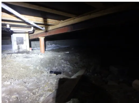
Delvis manglende plast mot grunnen i kryprom under stuedel.
