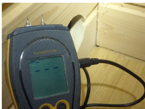
Fuktmåling i vegg til vaskerom.
