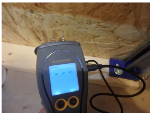
Fuktmåling i vegg bak veggmontert toalett.
