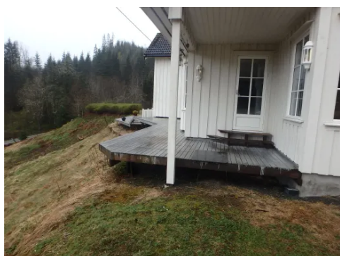
Ikke etablert rekkverk til terrasse.
