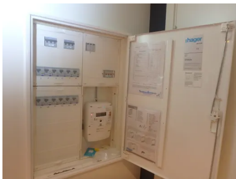
Sikringskap med automatsikringer er plassert på loftsgang.
