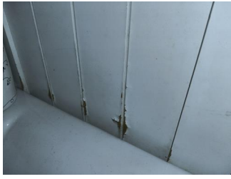
Sanitærutstyr og innredning - Svelleskader på høyskap
