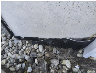
Fuktsikring av grunnmur - Skader i utvendig fuktsperre
