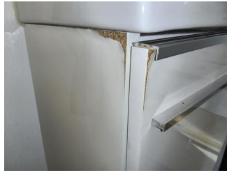
Sanitærutstyr og innredning - Skader i servant innredning
