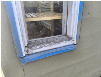
Vinduer, dører og porter - Skadet vindu
