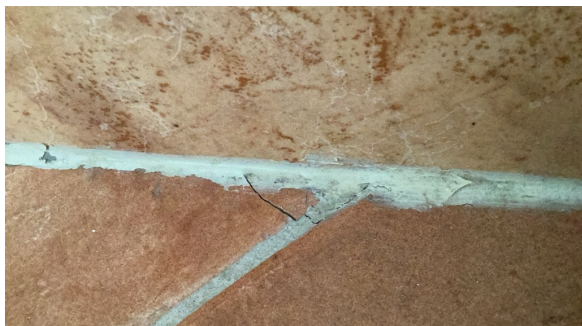
Sprekk i flis
