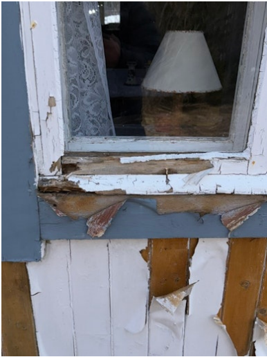
Råte i vindusrammen
