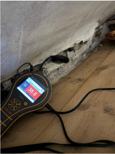
Fuktmåling i knevegg ved overgang til tak.
