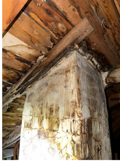
Tydelige tegn på tidligere vannlekasjer i yttertak.
