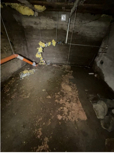
Tydelige fukt på grunnmur.
