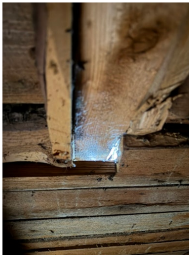
Lysinnslipp i yttertak
