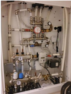
Fordelerskap og fordelerstammer - Fordelerskap.
