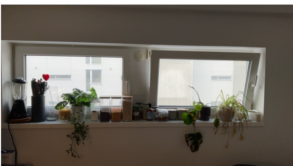
Kondensering rundt utsparing for vindu.
