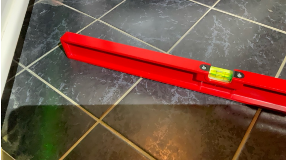
Motfall mot sluk under dusjkabinett.
