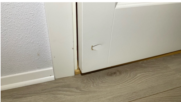
Støtskade på dørblad til bod.
