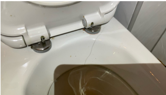
Riss/-sprekk i toalett.
