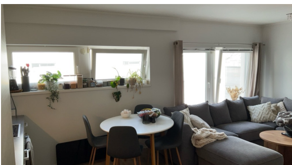
Misfargede overflater registreres særlig rundt vindusfelt.
