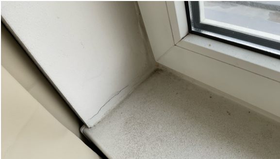
Begynnende skadeutvikling rund foring vindu.
