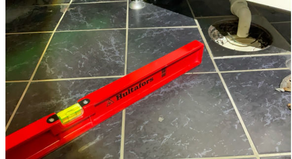
Flatt gulv mot sluk under servant.
