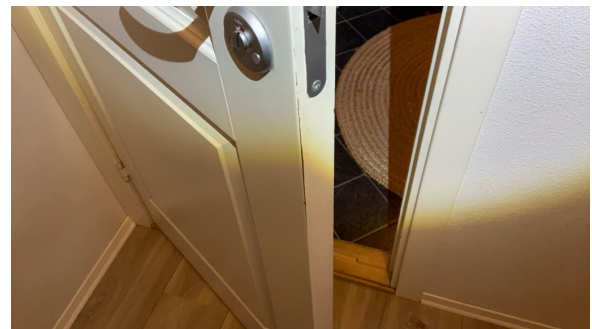
Innvendig dør til bad med synlig bruksslitasje.
