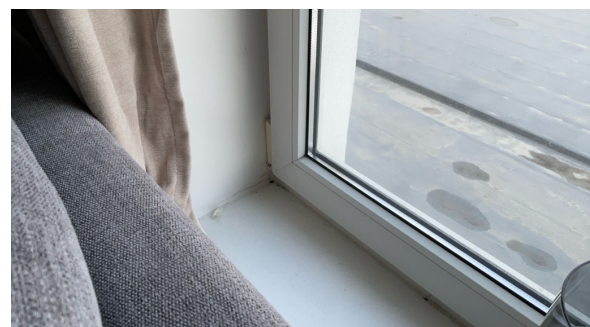
Kondensering rundt utsparing for vindu.
