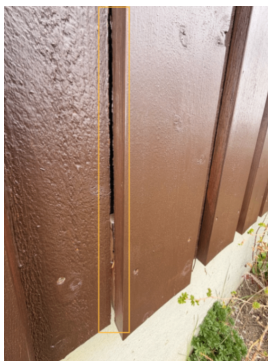
Åpning inn mellom under- og overligger.
