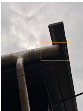
Det er registrert symptomer på utette endelokk på takrennene.
