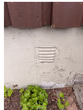
Mindre sprekkdannelser i utvendig puss.
