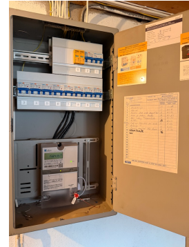
Sikringsskap med automatsikringer.
