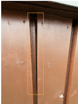
Åpning inn mellom under- og overligger
