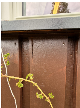
Oppsprukket kledningsbord etter innfestning.
