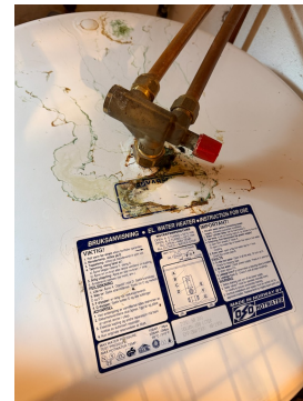
Synlige merker etter avrenning på toppen av berederen.
