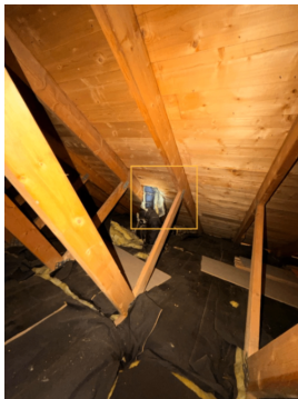
Det er registrert fuktskjolder rundt gjennomføring i tak.
