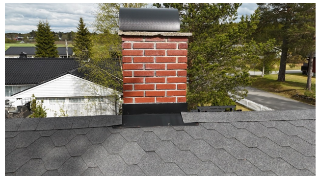
Pipe over tak.
