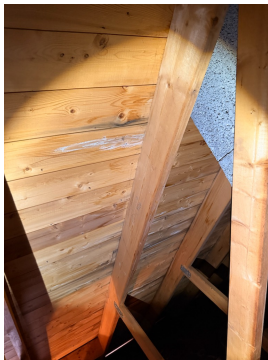
Det er registrert fuktskjolder på undertaket nedenfor pipen. Dette fremsto tørt på befaringstidspunktet.
