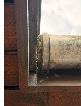
Det er registrert manglende endelokk.
