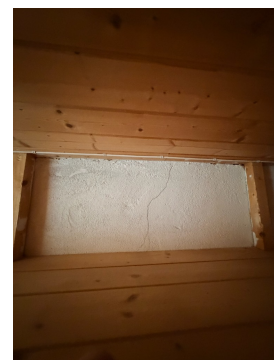
Sprekkdannelse i lettklinker bærevegg i kjeller.
