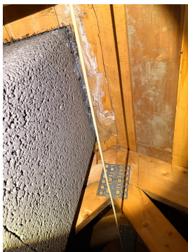
Saltutslag på treverk, dette forekommer normalt etter fukt påvirkning i konstruksjonen.
