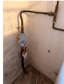
Inntak med hovedstoppekran.
