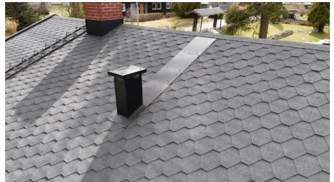
Lyrebeslaget er utført på en måte som medfører økt risiko for vanninntrengning ved kraftig nedbør.
