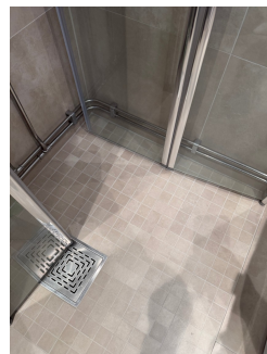
Bad gulv, nye fliser i dusjen 2026
