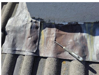
Skorsteiner (over tak) - Skader på bly ved skorstein.
