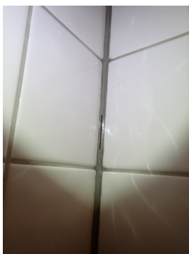
Eksempel på oppsprekking av fuge i hjørner (inne i dusjhjørne)
