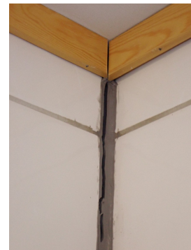
Oppsprekking i hjørne mot vest
