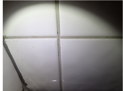
Eksempel på oppsprekking i fuger, ved hjørne mot vest
