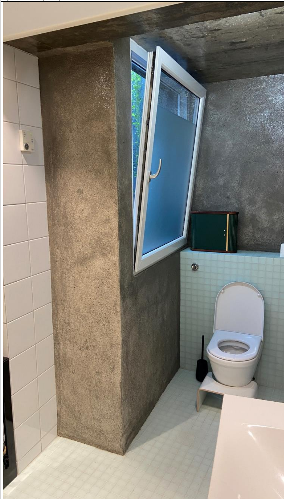
Foto nr. 31 Sprekk i murpuss på bad.
