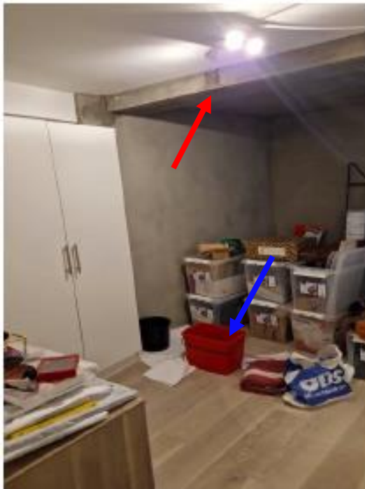
Bilde fra Frøiland Bygg Skade sin rapport, rød pil peker på lekkasjepunkt, bli pil på oppsamlingskar
