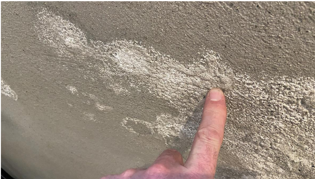
Økt saltutslag indikerer økt fuktvandring gjennom grunnmur i stue.
