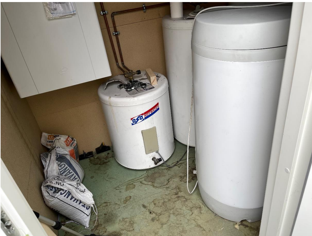
Bilde fra teknisk rom, ikke dokumentert når dette rommet er bygget
