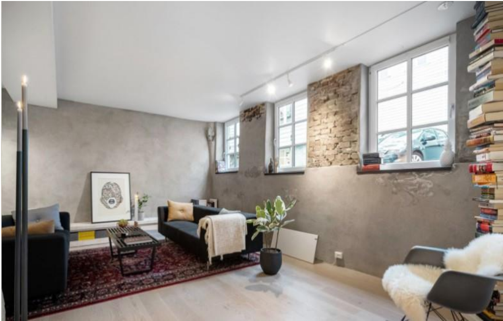
Oversiktsbilde av stuen hentet fra salgsoppgaven, ref. bilde over, fuktmerker de samme stedene og samme omfang
