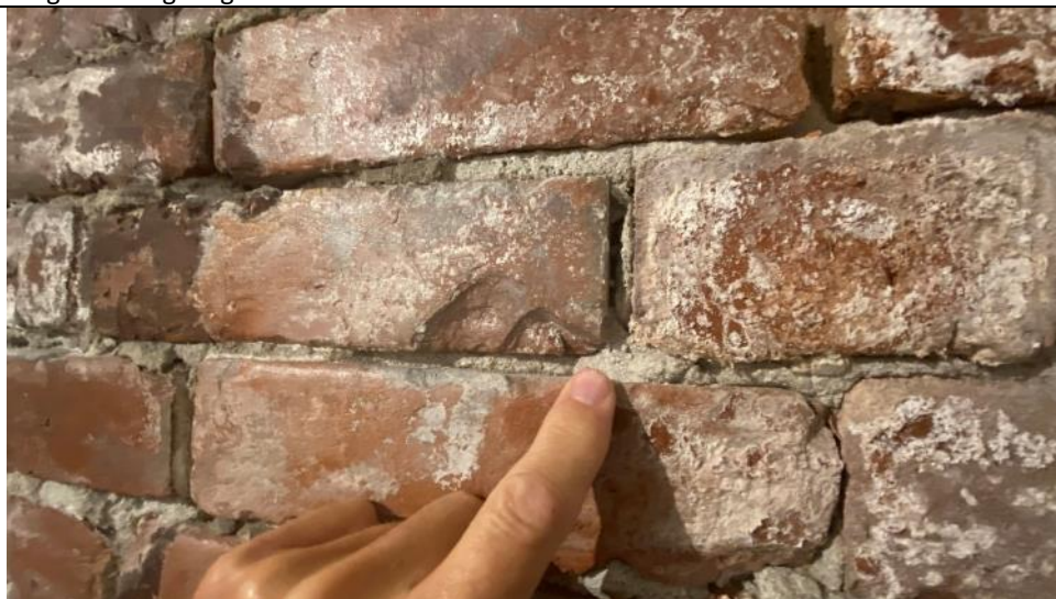
Foto nr. 15 Mager betong i fuger.
