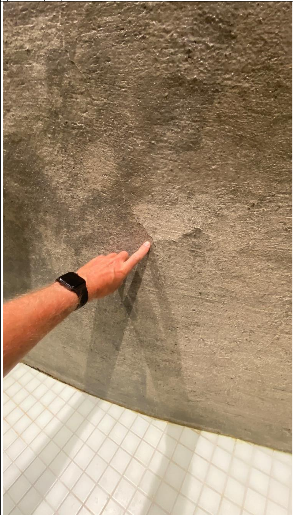
Foto nr. 30 Sprekk i murpuss på bad.
