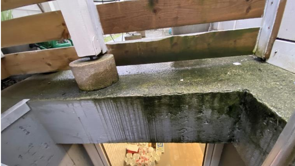
Ingen synlig membran over dekke ved lyssjakt / over støpt dekke (trolig fra 2016).
