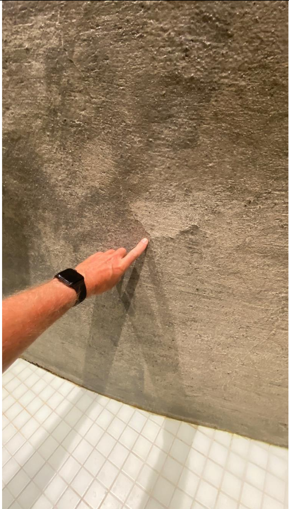
Foto nr. 30 Sprekk i murpuss på bad.
