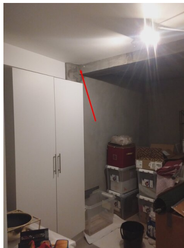
Oversikt. Pil viser lekkasjepunkt
