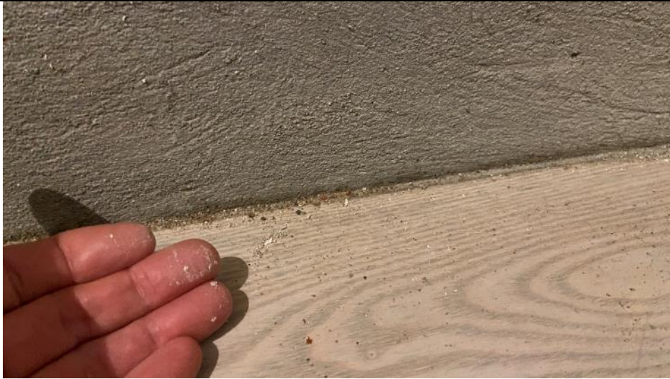
Foto nr. 21 Murdrøss og fukt i yttervegg / grunnmur.
