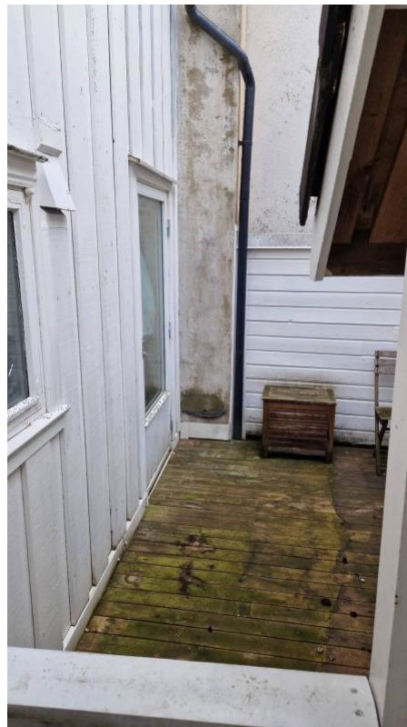
Lekkasje på innsiden oppstår rett under "terrassen" da dette er taket for ytterdelen i leiligheten
