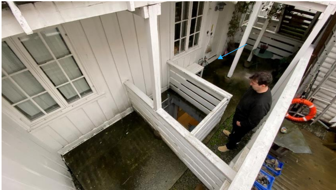
Lekkasjested ved bærebjelke i himling ligger omtrent under pil ved yttervegg til etasje over. Støpt dekke rundt lysåpning er trolig fra 2016.
