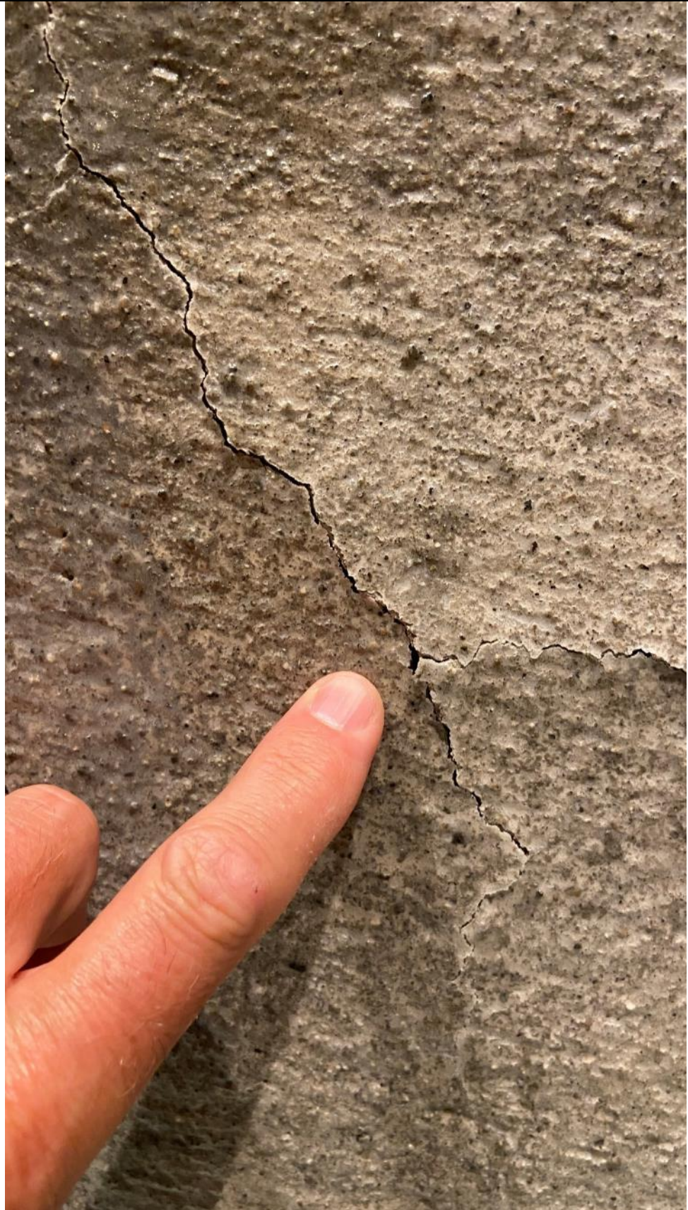
Foto nr. 29 Sprekk i murpuss på bad.
