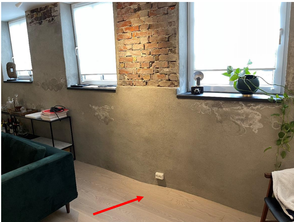
Rod pil peker på område hvor det ble observert fritt vann, gulvet har ingen skader
