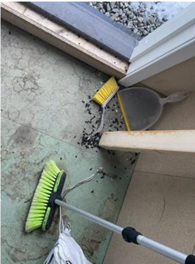
En del rotteekskremerer på gulv i boden.
