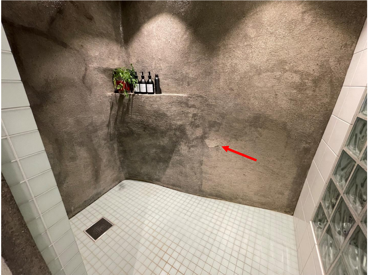
Bilde fra baderom tatt i september 2022. rød pil peker på område tilsvarende nærbilder i befæringsnotat fra takstmann Egeland
