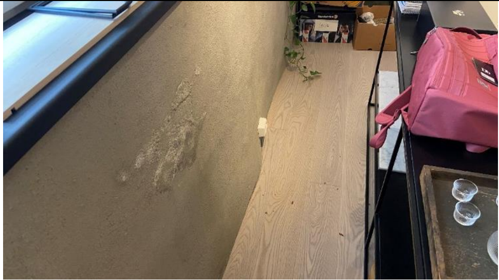
Foto nr. 11 Stue. Fuktmerker og saltutslag på grunnmur
