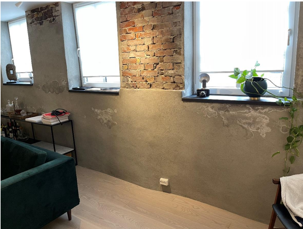
Ref. punkt om vinduer som er montert for lavt, dersom det kom vann inn under vinduene ville veggene være fuktige under vinduene, merk at det er bare et vindu hvor det er saltutslag under vinduet
