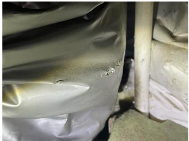
Bod. Fett merker på vannrør som følge av rotteaktivitet.
