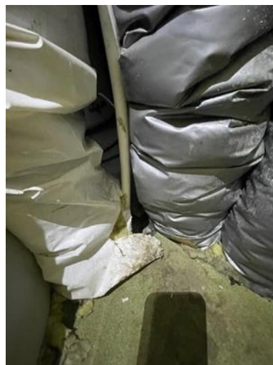
Bod. Tydelige spor etter rotter som går opp og ned ved rør.
