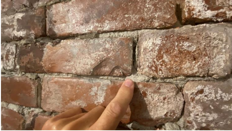
Foto nr. 15 Mager betong i fuger.
