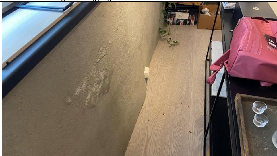
Foto nr. 11 Stue. Fuktmerker og saltutslag på grunnmur
