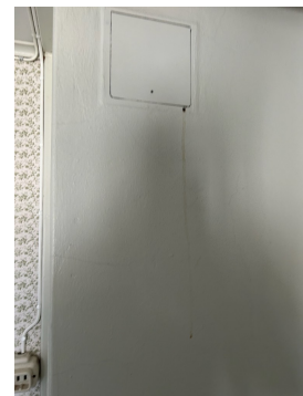
Avrenning av sotvann fra luke på pipe.
