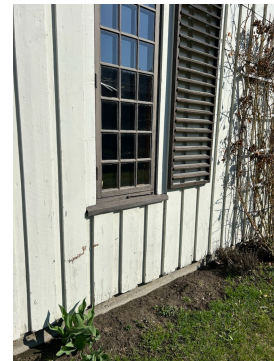
Værslitt kledning, med råteskader i nedrekant.
