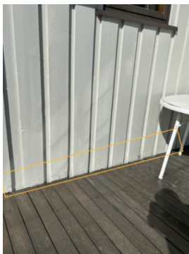
Råteskadet kledning er registrert.
