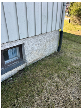
Ikke synlig fuktsikring av grunnmuren utvendig.
