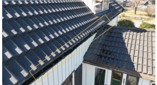
Store mengder mose i takrenne.
