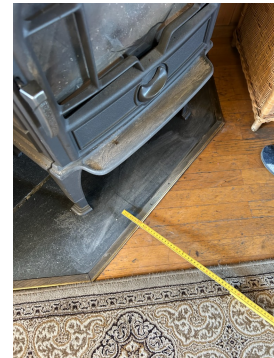
Manglende ubrennbar plate under/foran vedovn.
