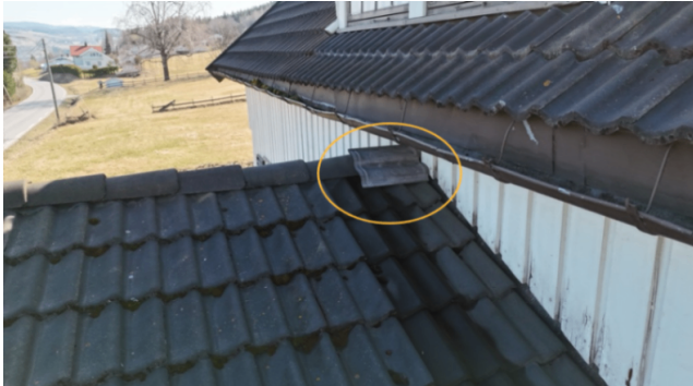
Løs takstein ligger på takoverbygg.
