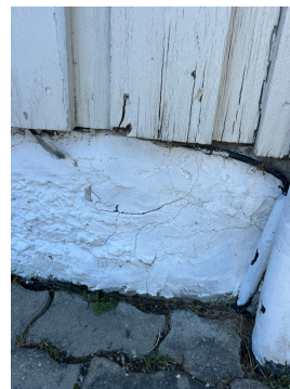
Sprekkdannelser i utvendig puss på grunnmuren.
