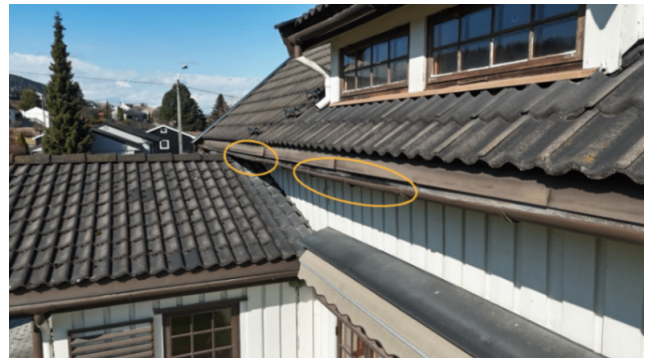
Takrenner har store deformasjoner.
