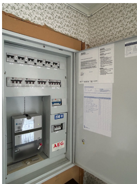
Sikringssskap med automatsikringer.
