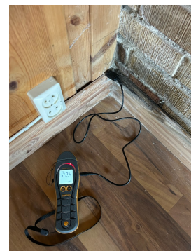
Synlig tegn på innvendig trepanel på økt fuktbelastning, dette bekrefte ved fuktmåling i trepanelet.
