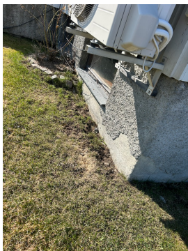
Ikke synlig fuktsikring av grunnmuren utvendig. Vann fra varmepumpen kan trenge ned langs grunnmuren og inn i konstruksjonen.
