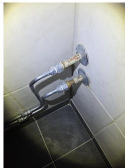
Vannrør - Vannrør av kobber.
