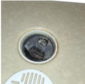
Avløp (inkl. sluk) - Sluk under vask
