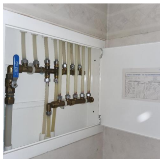
Fordelerskap og fordelerstammer
