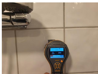
Kontroll i tilliggende konstruksjon ikke utført - Fuktsøk 2
