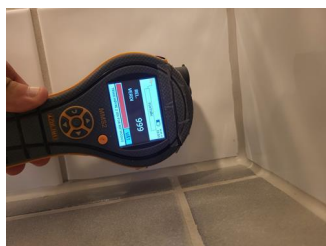
Kontroll i tilliggende konstruksjon ikke utført - Fuktsøk 3
